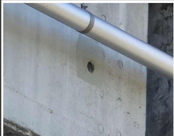
위 치 거더 S4-G1 현 황 인양홀 박락 보수
