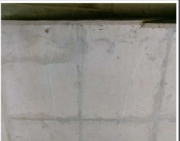
위 치 교대 A1 현 황 균열(Cw<0.3mm)
