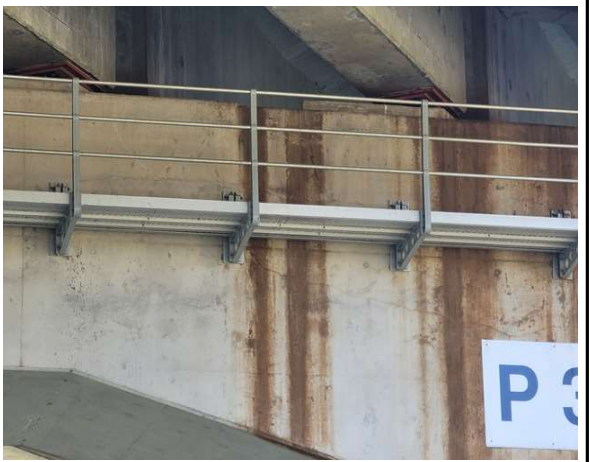
위 치 교각 P3 현 황 균열(Cw<0.3mm)
