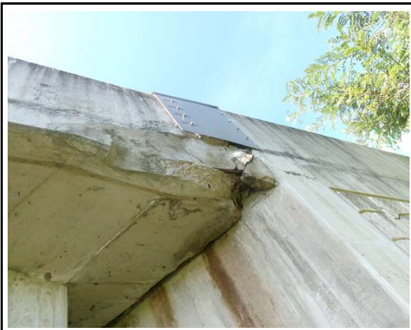
위 치 바닥판하면 S1 현 황 파손 및 철근노출(A=1.5m×0.5m)
