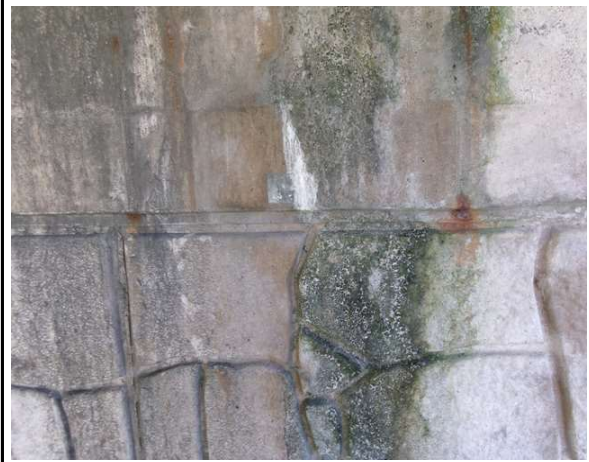
위 치 교대 A2 현 황 균열부백테(A=0.1m×0.3m)
