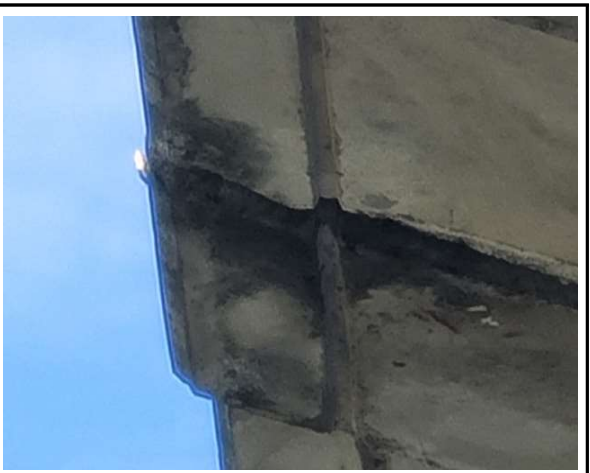
위 치 바닥판하면 S3 현 황 캔틸레버 박리(A=0.2m×0.5m)
